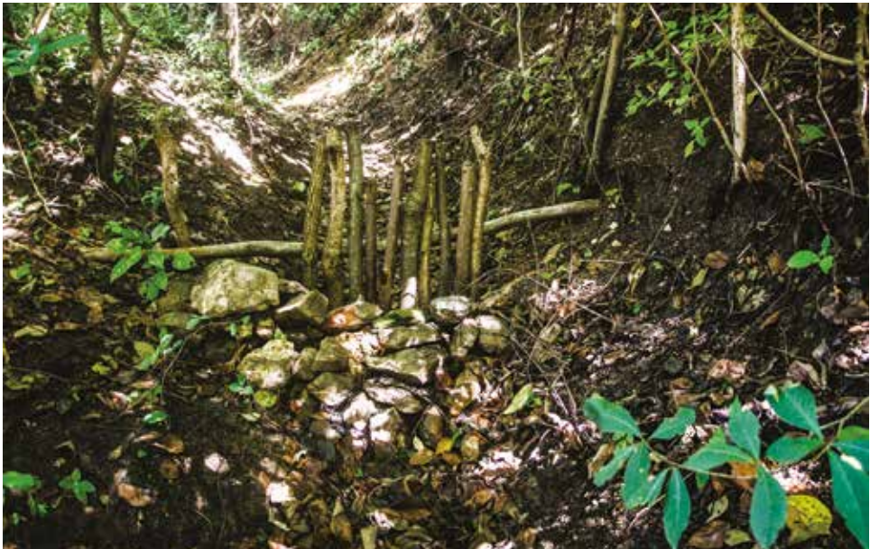
Los diques actúan como disipadores de energía, pues reducen la fuerza de la escorrentía que desemboca en el reservorio y retienen los sedimentos. Foto: CATIE.
