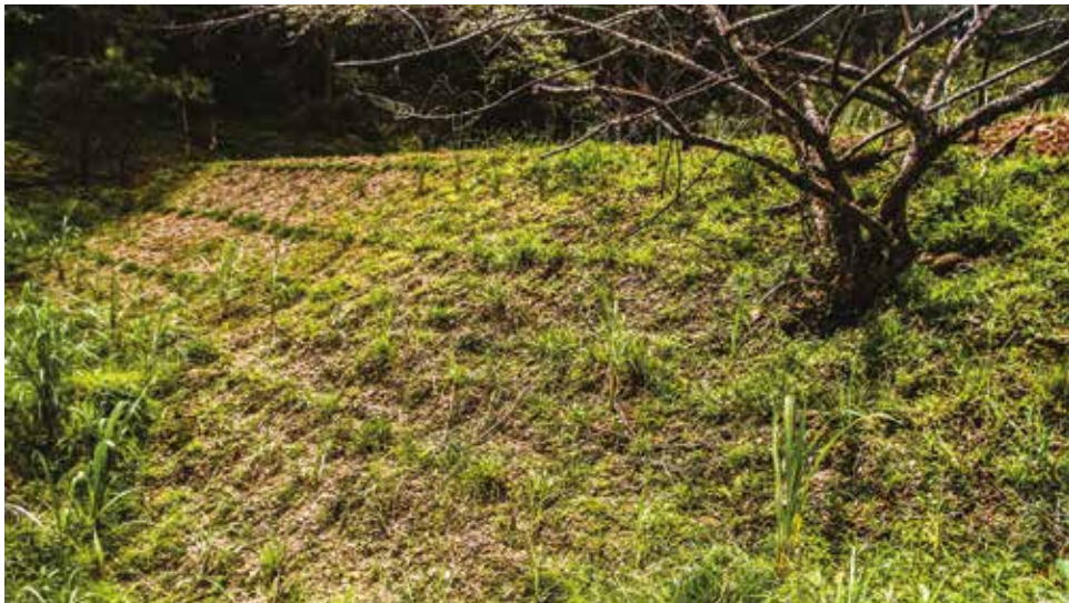
Talud externo protegido con pastos naturales. Las raíces del arbusto pueden convertirse en un problema futuro, pues podrían llegar a romper el talud. Foto: CATIE.
