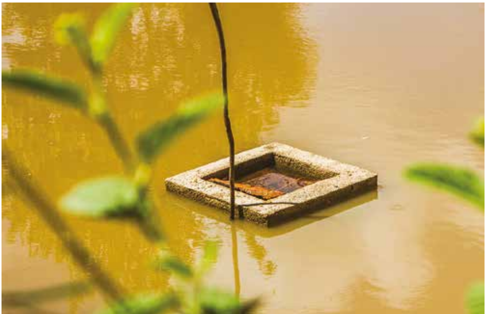
Obra de toma desprotegida de la entrada de sedimentos y basura gruesa, como hojas o ramas que pueden obstruir la tubería de desagüe. Foto: CATIE.
