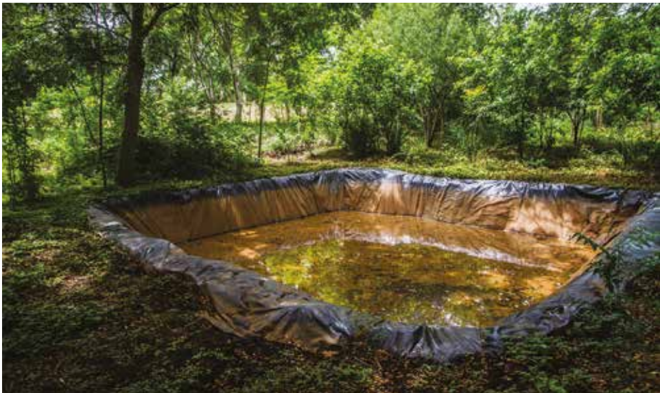
La ausencia de obras de retención de sedimentos en el área de recarga y la falta de limpieza del reservorio dañan rápidamente la estructura. Foto: CATIE.
