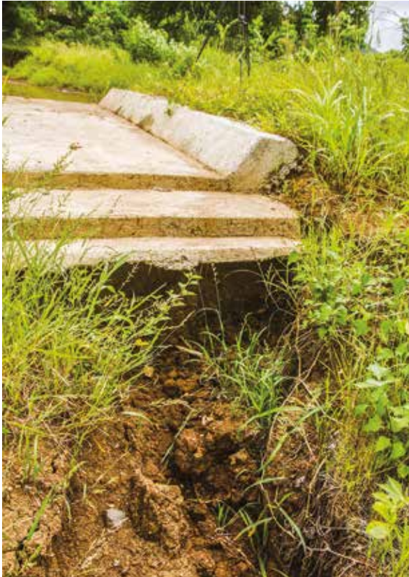
Vertedero con daños por erosión, que debe ser reparado cuanto antes para evitar mayores daños. Foto: CATIE.
